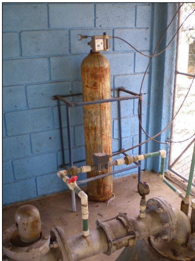
Figura 2.2. Sistema de cloración del Pozo #1.
