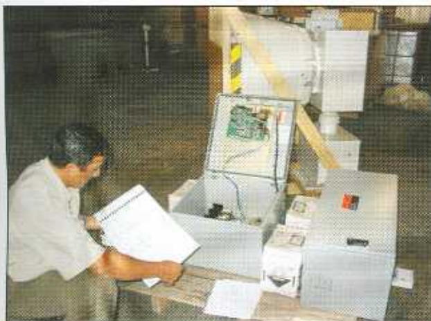
Instrumentos y equipos utilizados como alarma en sistema de alerta temprana Tapezco, Santa Ana
