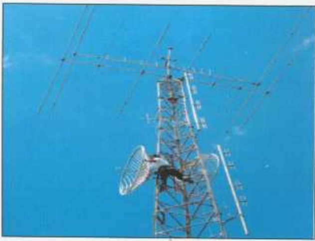
Torre de comunicaciones. Base O Sede Central C N E
