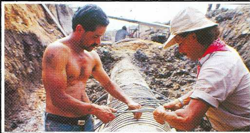
Poco tiempo después del terremoto el Instituto Costarricense de Acueductos y Alcantarillados inició la reparación del acueducto de Limón.
