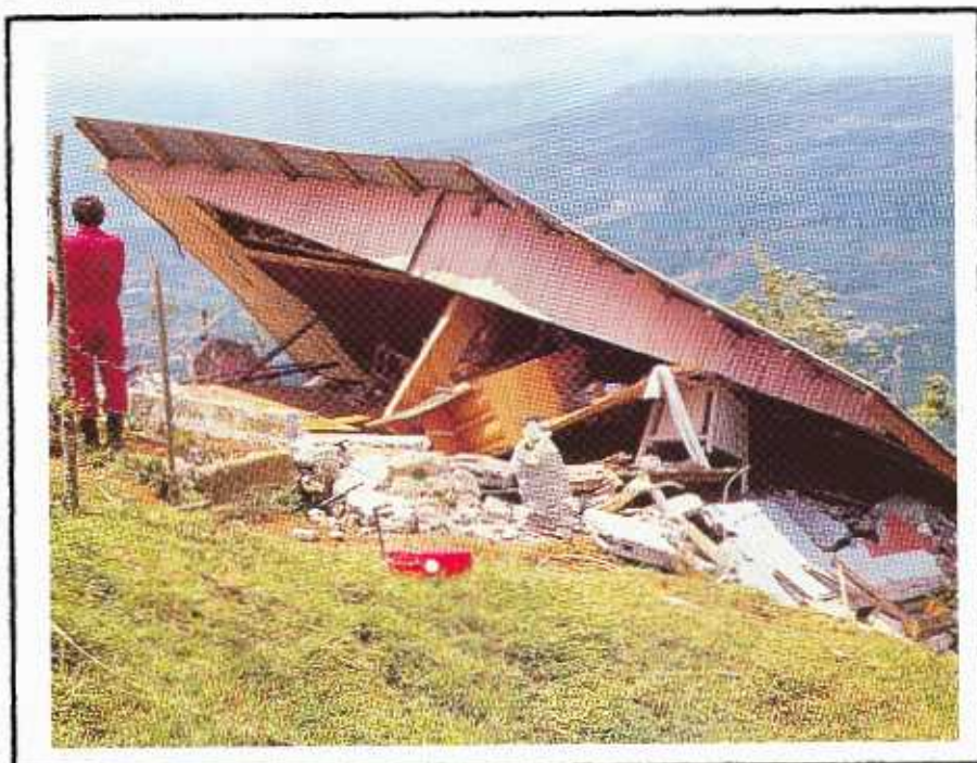
La construcción en terrenos no aptos y la utilización de materiales y técnicas inadecuadas, son las principales causas de los daños en viviendas cuando ocurren sismos.
