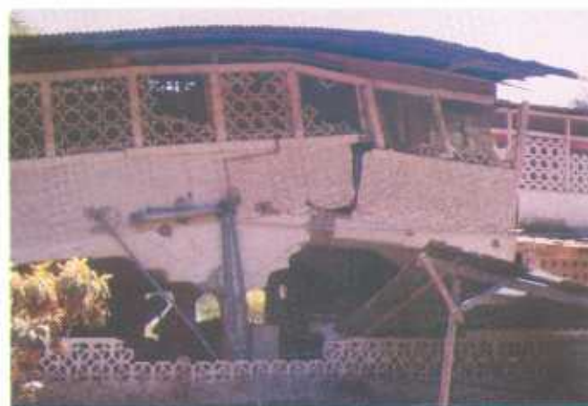
Los lugares de Cóbano, Mata de Limón y el centro de Puntarenas, fueron los más afectados por el terremoto del Cóbano del 25 de marzo de 1990.
